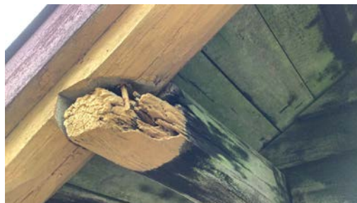
Råteskadet ende av toppsvill.
