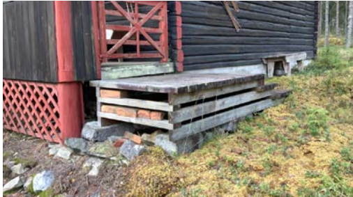
Trapp mangler rekkverk.
