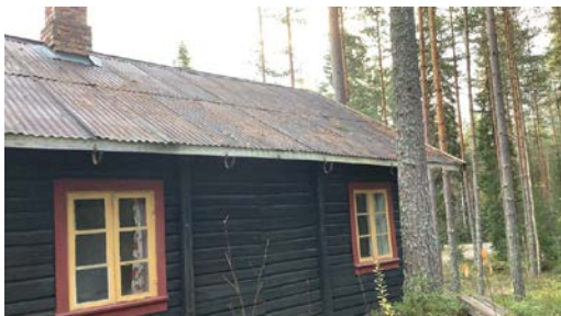
Skjevheter i takkonstruksjonen.
