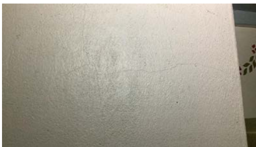
Eksempel på riss i puss på pipe.
