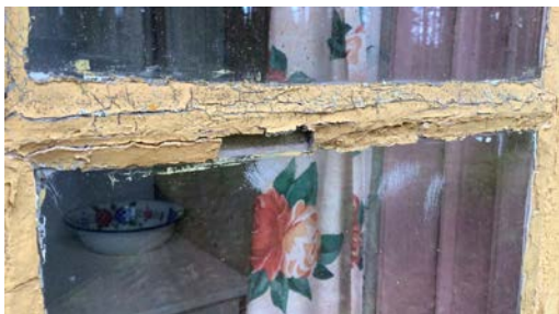
Eksempel på værslitt vindu.
