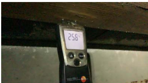
Det måles skadelig fuktinnhold i treverk i krypjkjeller.
