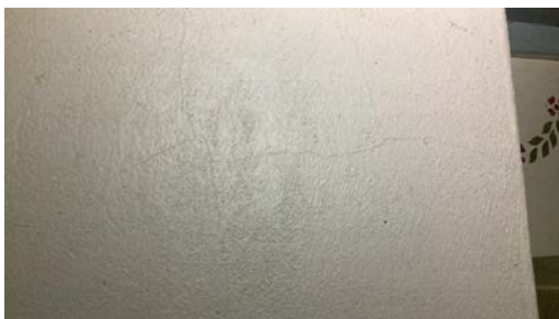
Eksempel på riss i puss på pipe.
