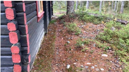
Utilfredsstillende fall fra bygning.
