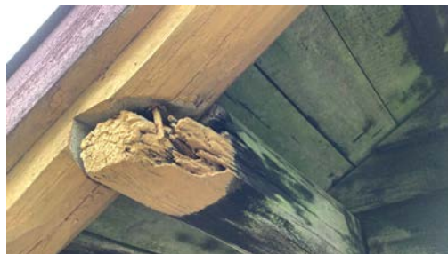
Råteskadet ende av toppsvill.
