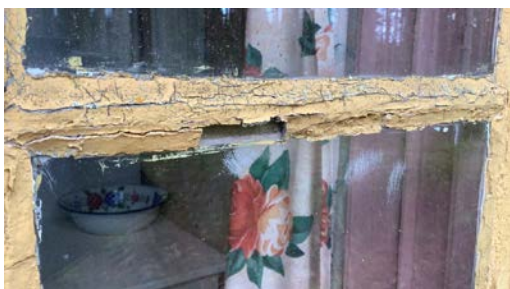
Eksempel på værslitt vindu.
