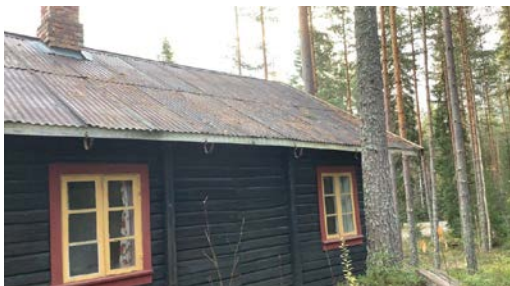
Skjevheter i takkonstruksjonen.
