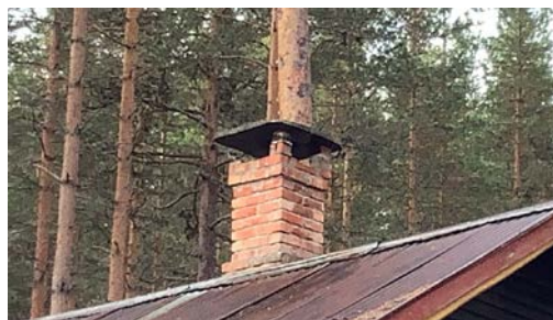
Manglende murstein på hjørne under steinhelle på pipe.
