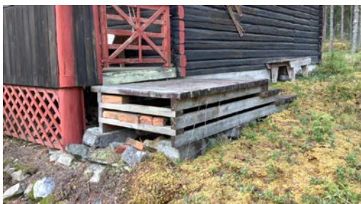
Trapp mangler rekkverk.
