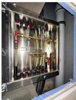
Samleskap med rørkurser og stoppekraner
