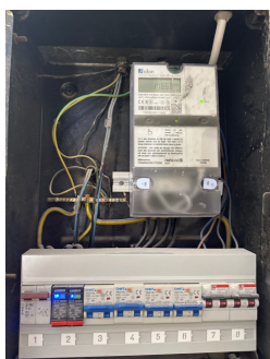
Sikringsskap med automatsikringer.
