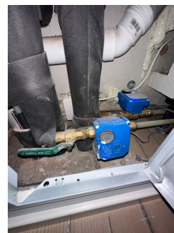
Stoppekraner plassert i luke på kjøkken
