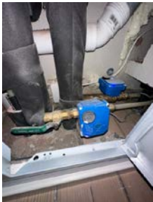
Stoppekraner plassert i luke på kjøkken
