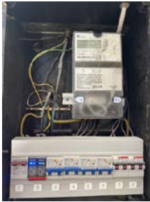
Sikringsskap med automatsikringer.
