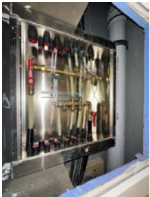
Samleskap med rørkurser og stoppekraner
