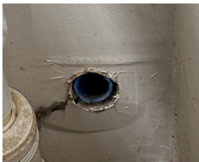
Skader gips ved gammel rør gjennomføring
