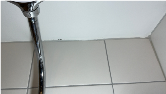
Ujevn og oppspukket fugemasse
