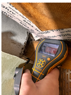
Høyere fuktighet enn det som er akseptabelt
