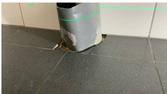
Membran som kommer opp under baderomsinnredning
