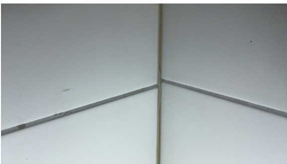
Høydeforskjell på fliser
