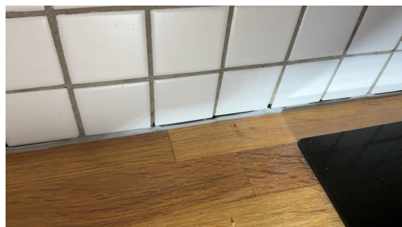
Silikon som slipper mellom vegg og benkeplate
