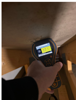
Høyere fuktighet enn det som er akseptabelt
