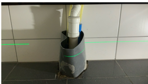
Manglende tetting i toppen av membranen
