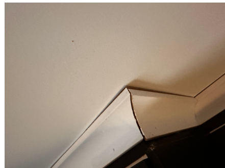
Taklist som gliper i skjøt, og ikke ligger helt opptil taket
