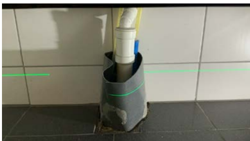
Manglende tetting i toppen av membranen
