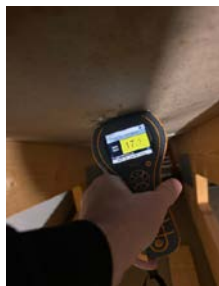
Høyere fuktighet en det som er akseptabelt
