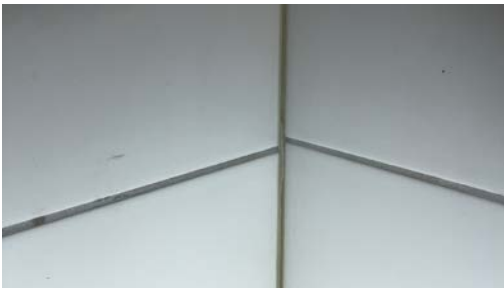
Høydeforskjell på fliser
