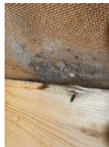
Oppdaget noe mygg/soppvekst på undertaket i nærheten av pipen
