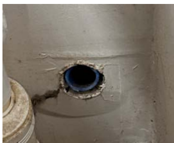
Skader gips ved gammel rør gjennomføring
