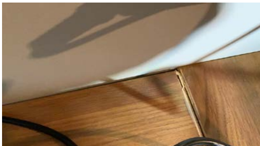
Glippe i benkeplateskjøt
