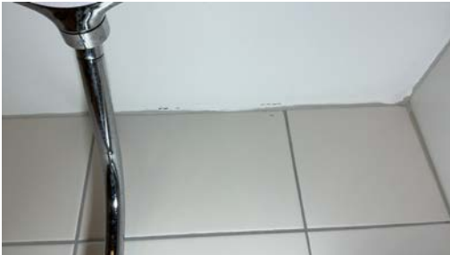
Ujevn og oppspukket fugemasse
