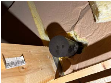
Luftingen av avløpet er avsluttet på loft med blindlokk
