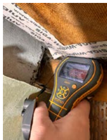
Høyere fuktighet en det som er akseptabelt
