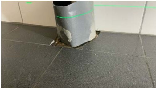
Membran som kommer opp under baderomsinnredning
