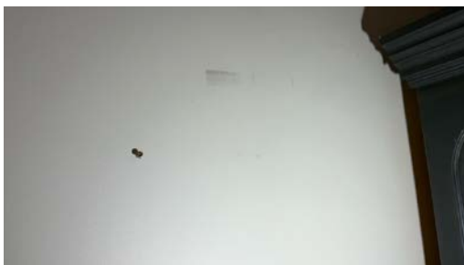
Merker i tak på soverommet
