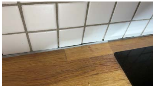
Silikon som slipper mellom vegg og benkeplate
