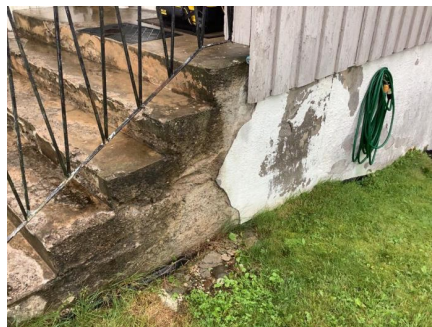
Eksempel på løsnet puss.
