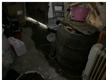
Regnvann renner rett inn i kjeller.
