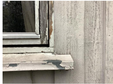
Eksempel på værslitt vindu.
