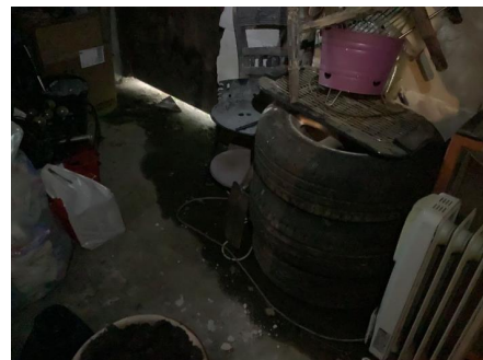
Regnvann renner inn under kjellerdør.
