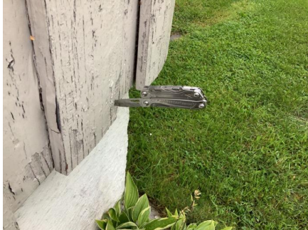
Sprede råteskader i bordkledningen.
