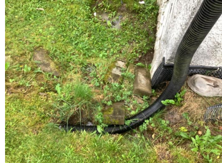
Mangelfull borledning av takvann.
