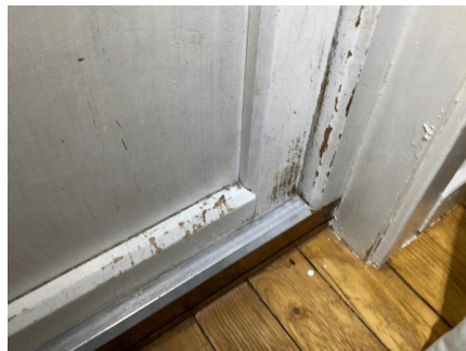
Innvendig slitasje på balkongdør.
