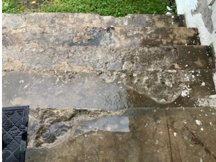
Skader i støpt trapp.
