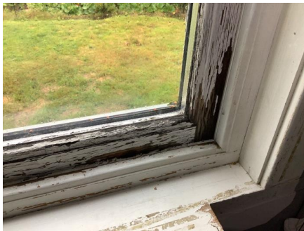
Eksempel på innvendig slitasje.
