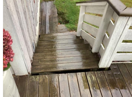
Skjevheter i tretrapp og denne har løsnet fra terrassen.
