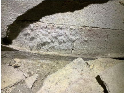
Saltutslag på grunnmur.
