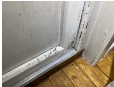
Innvendig slitasje på balkongdør.
