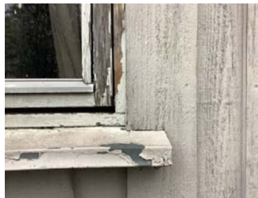
Eksempel på værslitt vindu.
