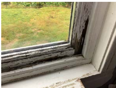
Eksempel på innvendig slitasje.
