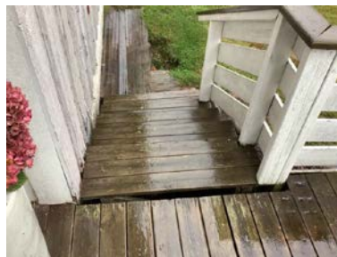
Skjevheter i tretrapp og denne har løsnet fra terrassen.
