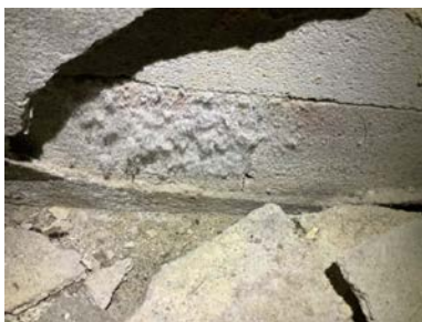
Saltutslag på grunnmur.
