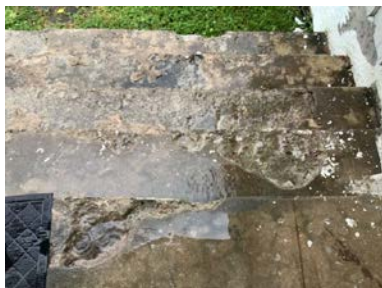
Skader i støpt trapp.
