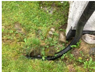
Mangelfull borledning av takvann.
