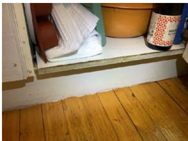
Svellskadet bunnplate, og skap holder på å løsne fra hverandre.
