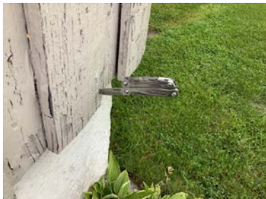
Spredte råteskader i bordkledningen.
