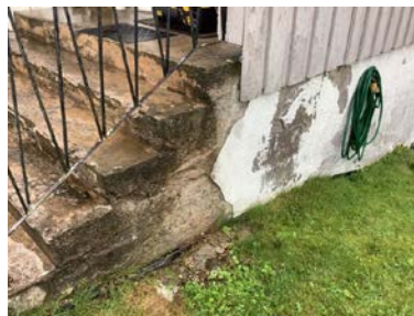
Eksempel på løsnet puss.
