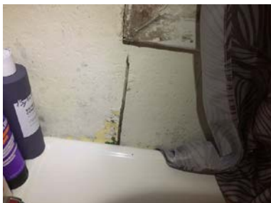
Utett tettesjikt i våtsonen, og indikasjoner på at det er skade i yttervegg.
