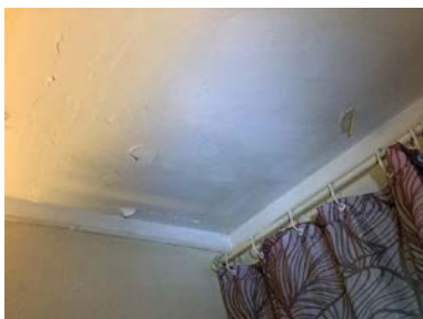
Maling har løsnet i himling.
