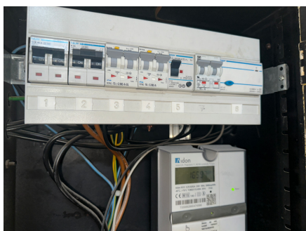
Sikringsskap plassert i felles oppgang.
