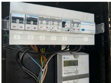
Sikringsskap plassert i felles oppgang.
