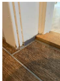
Vinylbelegg oppdratt langs utføring ved dør.
