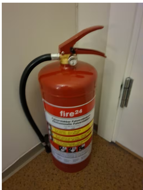
Brannslukningsapparat er plassert i entré.
