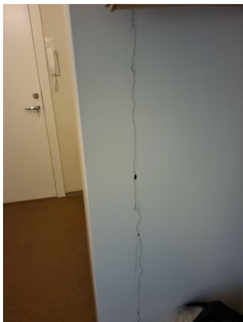
Sprekk/riss i vegg i entré.
