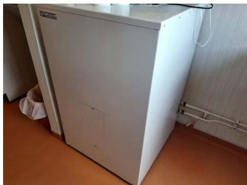
Varmtvannsbereder er plassert på bad.
