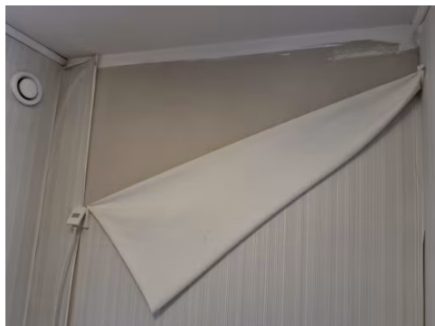
Våtromstapet har løsnet.
