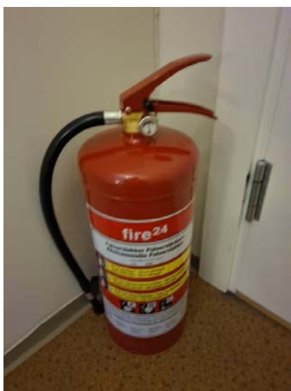
Brannslukningsapparat er plassert i entré.
