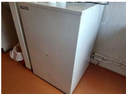
Varmtvannsbereder er plassert på bad.
