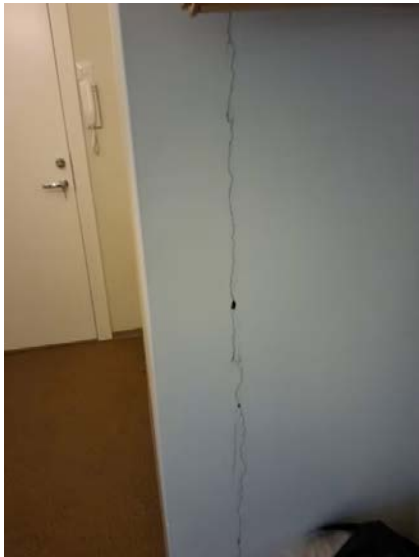
Sprekk/riss i vegg i entré.
