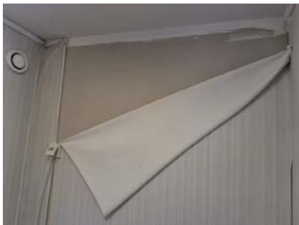
Våtromstapet har løsnet.
