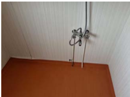
Det registreres skadet og løsnet våtromstapet.
