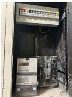
Sikringsskap med automatsikringer.
