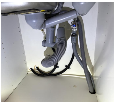
Interne avløpsrør i plast
