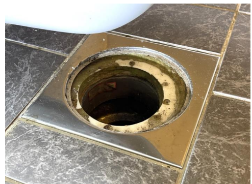
Sluk under veggtoalett
