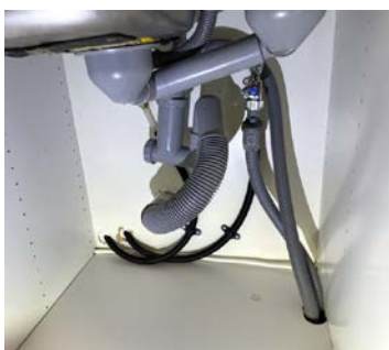
Interne avløpsrør i plast
