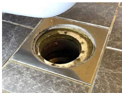
Sluk under veggtoalett
