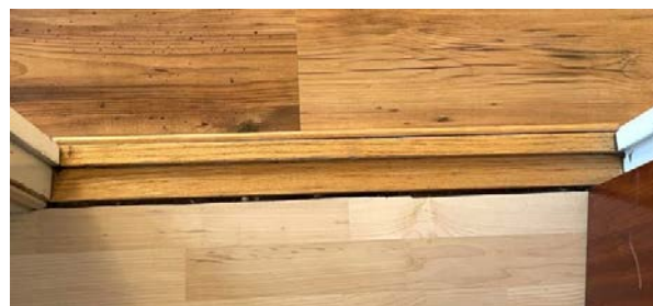
Glippe mellom laminat og dørterskel
