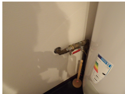
Stoppekran på vaskerom.
