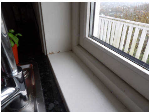
Noe slitasje på foringer til vindu på kjøkkenet.
