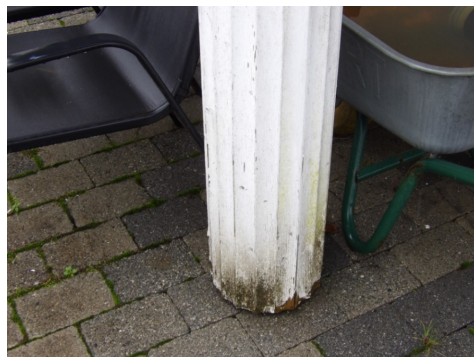
Dårlige sekos til tresøyler.
