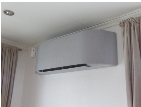
Varmepumpe i stue.
