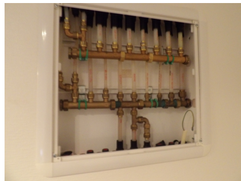
Rør i rør sentral på vaskerom.
