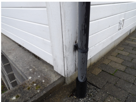
Råteskade og oppsprekk på hjørnebord.
