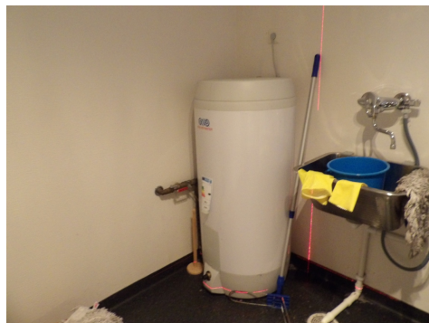
Varmtvannsbereider på vaskerom.
