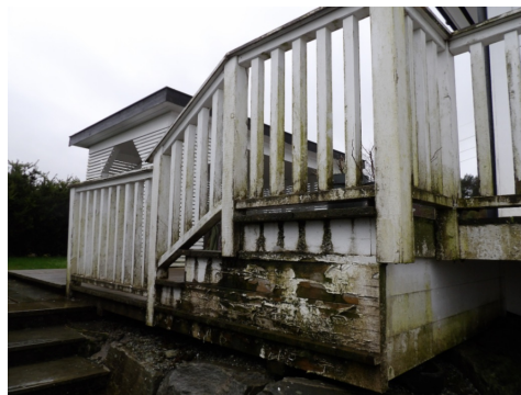
Begynnende råteskader på rekkverk.
