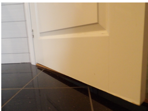
Slitasje på nedre del av dørblad på dør til badet.
