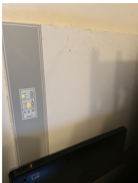
Balansert ventilasjonsanlegg i boligen.
