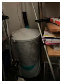
Sentralstøvsuger i teknisk rom.
