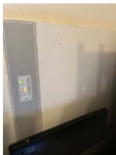
Balansert ventilasjonsanlegg i boligen.
