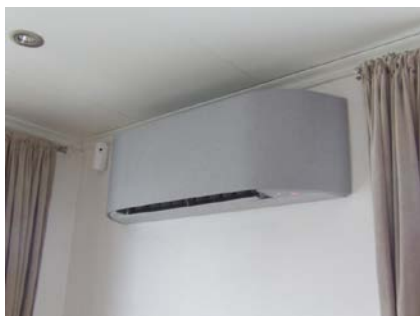
Varmepumpe i stue.
