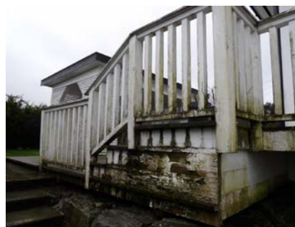
Begynnende råteskader på rekkverk.
