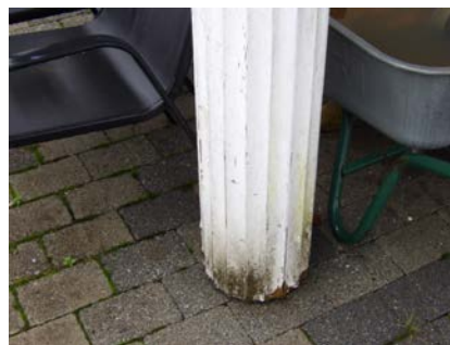
Dårlige sekos til tresøyler.
