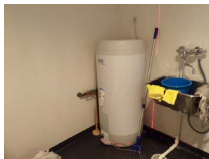
Varmtvannsbereder på vaskerom.
