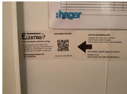
Qr kode for dokumentasjon plassert i sikringskap.
