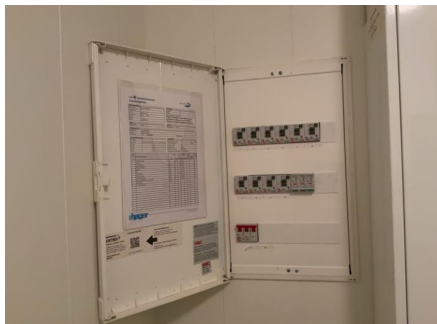
Sikringskap plassert på teknisk rom.
