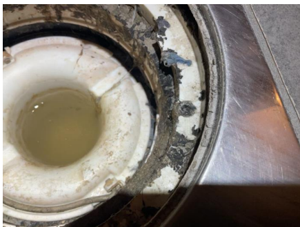
Skruer på klemring er strammet for hardt og er deformert. Klemring kan ha ujevnt trykk mot slukmansjett.
