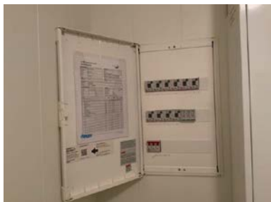
Sikringskapp plassert på teknisk rom.
