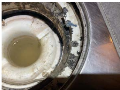
Skrue på klemring er strammet for hardt og er deformert. Klemring kan ha ujevnt trykk mot slukmansjett.
