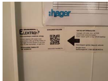
Qr kode for dokumentasjon plassert i sikringskapp.
