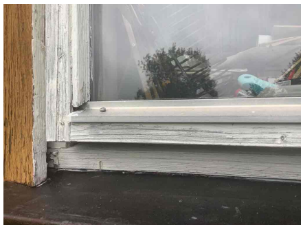
Eksempel på slitasje.
