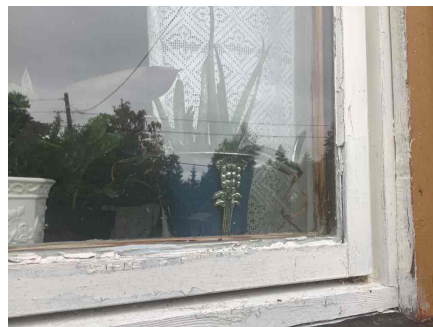
Eksempel på slitasje.
