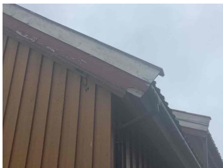
Eksempel på slitasje på vindski.
