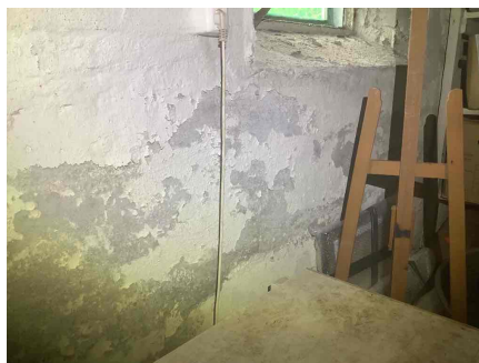
Eksempel på avskaling/saltutslag.
