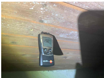
Fuktmåling i himling på 20 vektprosent.
