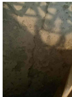
Eksempel på sprekk i grunnmur.
