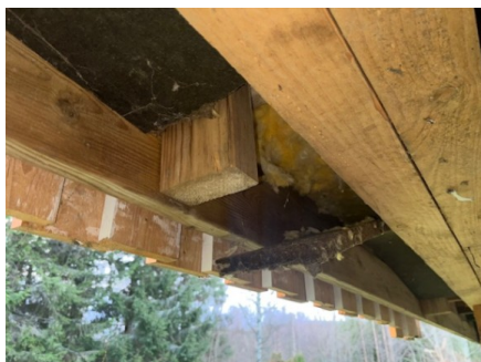
Eksempel på løs asfaltplate og åpent inn til isolasjon.
