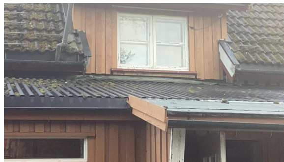
Usikker tetting i overganger.
