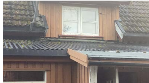
Usikker tetting i overganger.
