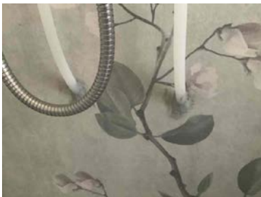
Gjennomføringer i våtsone tette med fugemasse.
