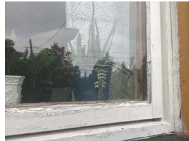
Eksempel på slitasje.
