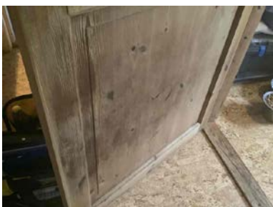
Eksempel på slitasje.
