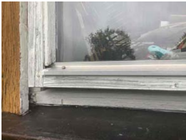
Eksempel på slitasje.
