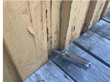
Råte i kledning over kjellernedgang.
