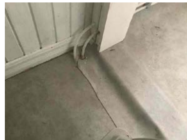
Utførelse på bad fremstår generelt ufagmessig.
