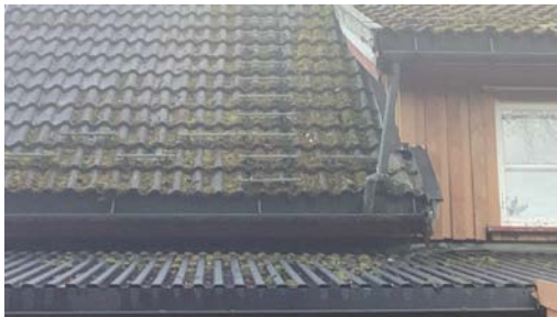
Stedvis kraftig mosevekst.
