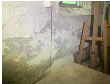
Eksempel på avskaling/saltutslag.
