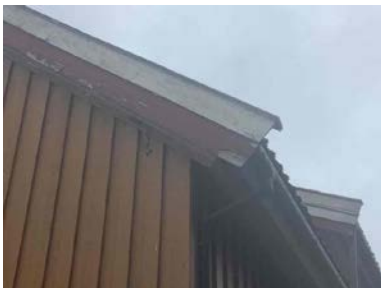
Eksempel på slitasje på vindski.
