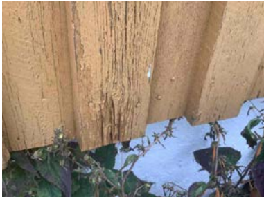
Eksempel på oppsprekking.
