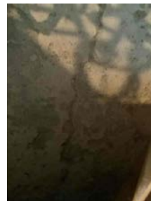
Eksempel på sprekk i grunnmur.
