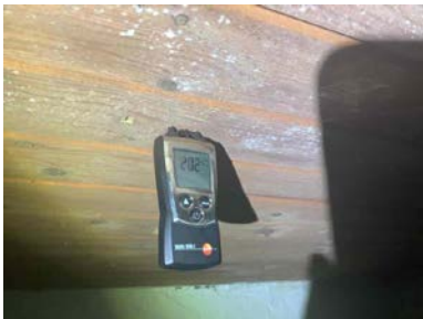
Fuktmåling i himling på 20 vektprosent.
