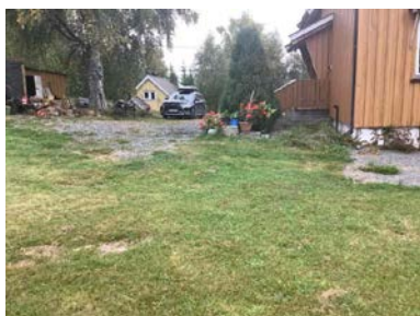
Fall på terreng mot bygget mellom bolighus og uthus.
