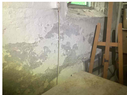
Eksempel på avskaling/saltutslag.
