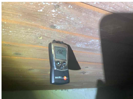
Fuktmåling i himling på 20 vektprosent.
