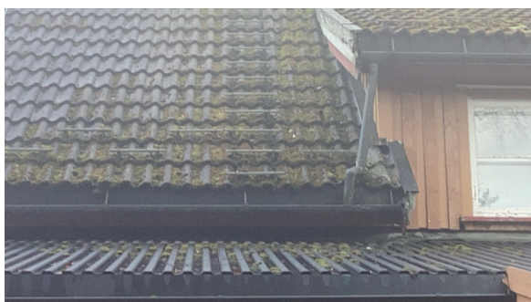
Stedvis kraftig mosevekst.
