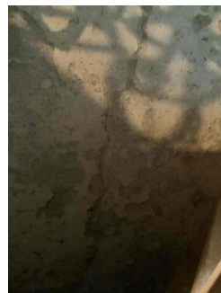
Eksempel på sprekk i grunnmur.
