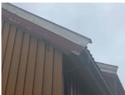
Eksempel på slitasje på vindski.
