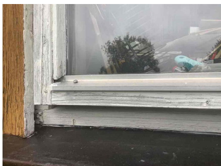
Eksempel på slitasje.
