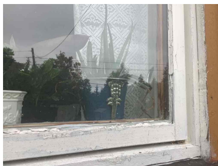
Eksempel på slitasje.
