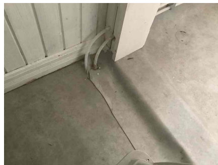
Utførelse på bad fremstår generelt ufagmessig.
