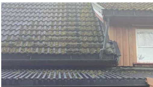
Stedvis kraftig mosevekst.
