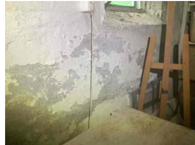
Eksempel på avskaling/saltutslag.
