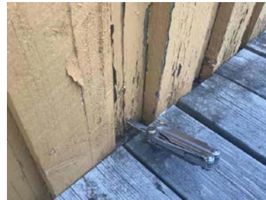
Råte i kledning over kjellernedgang.
