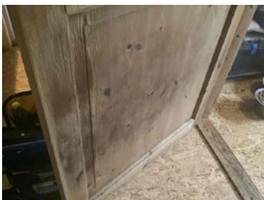
Eksempel på slitasje.
