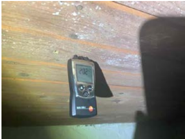
Fuktmåling i himling på 20 vektprosent.
