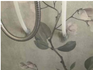
Gjennomføringer i våtsone tette med fugemasse.
