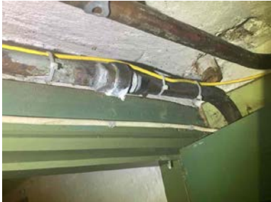
Drypplekkasje fra flere rørsjøter.
