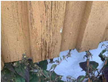
Eksempel på oppsprekking.
