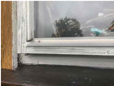
Eksempel på slitasje.
