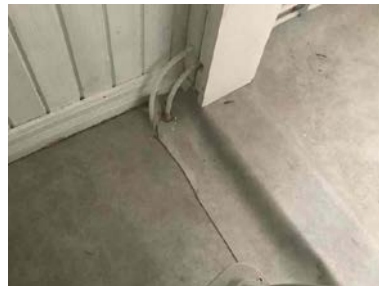
Utførelse på bad fremstår generelt ufagmessig.
