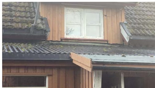
Usikker tetting i overganger.
