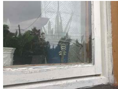
Eksempel på slitasje.
