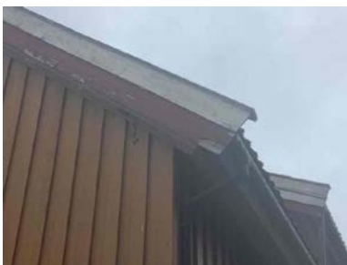
Eksempel på slitasje på vindski.
