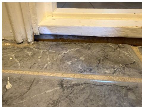
Utett overgang inn mot terskel dør til gang
