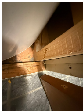
Vannmerke i bunn stender, ingen oppbrett av membran mot skillevegg
