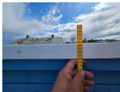
Rekkverk målt til ca. 95 cm.
