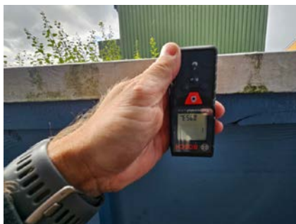
Rekkverk målt til ca. 95 cm.
