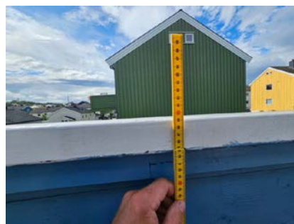
Rekkverk målt til ca. 89 cm.
