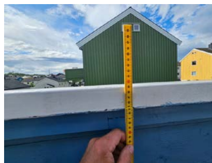
Rekkverk målt til ca. 89 cm.
