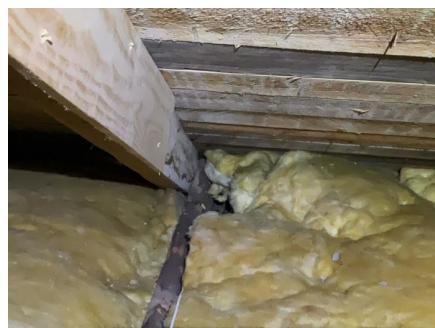
Isolasjonen ligger stedvis ujevnt på loft.
