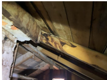
Tydlig lekkasjer rundt pipe. Disse var tørre på befaringstidspunktet.
