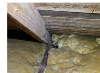
Isolasjonen ligger stedvis ujevnt på loft.
