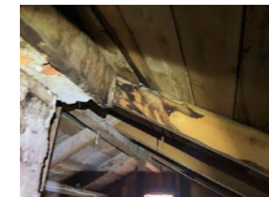
Tydelig lekkasjer rundt pipe. Disse var tørre på befaringstidspunktet.
