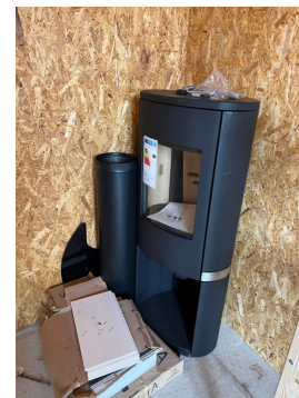
Vedovn og stålrør er plassert i bod.-
