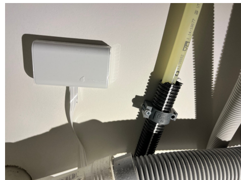
Manglende tetting av varerør i kjøkkenbenk.
