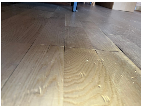
Parkett i stue med sprekker og merker.
