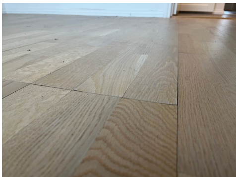
Parkett på soverom med sprekker.
