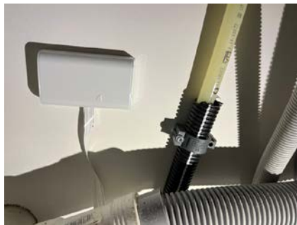
Manglende tetting av varerør i kjøkkenbenk.
