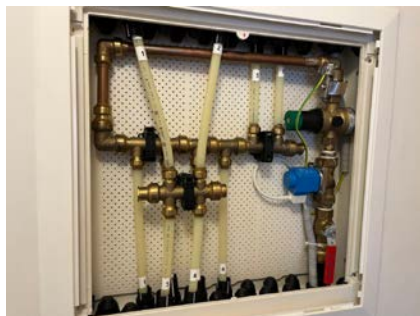
Fordelerskap for vann med stoppekran.
