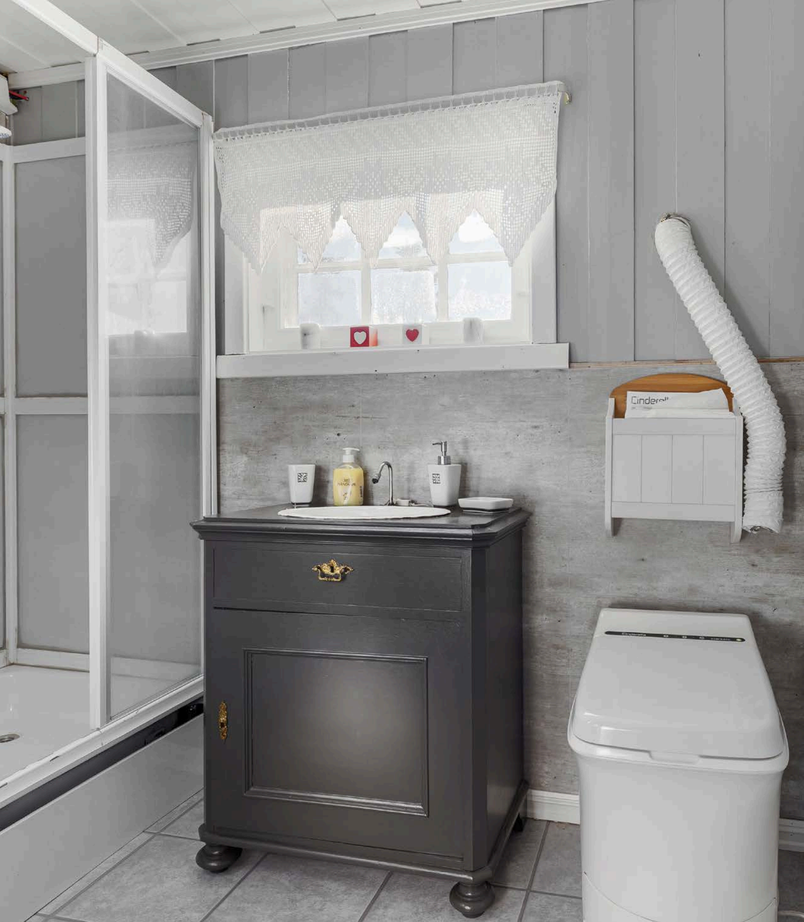
Lyst enkelt baderom uten sluk/avløp. Rommet har laminat på gulv, malt trepanel på veggene og et vindu som slipper inn naturlig lys. I 2022 ble det satt inn toalett Cinderella forbrenningsovn på badetrom.
