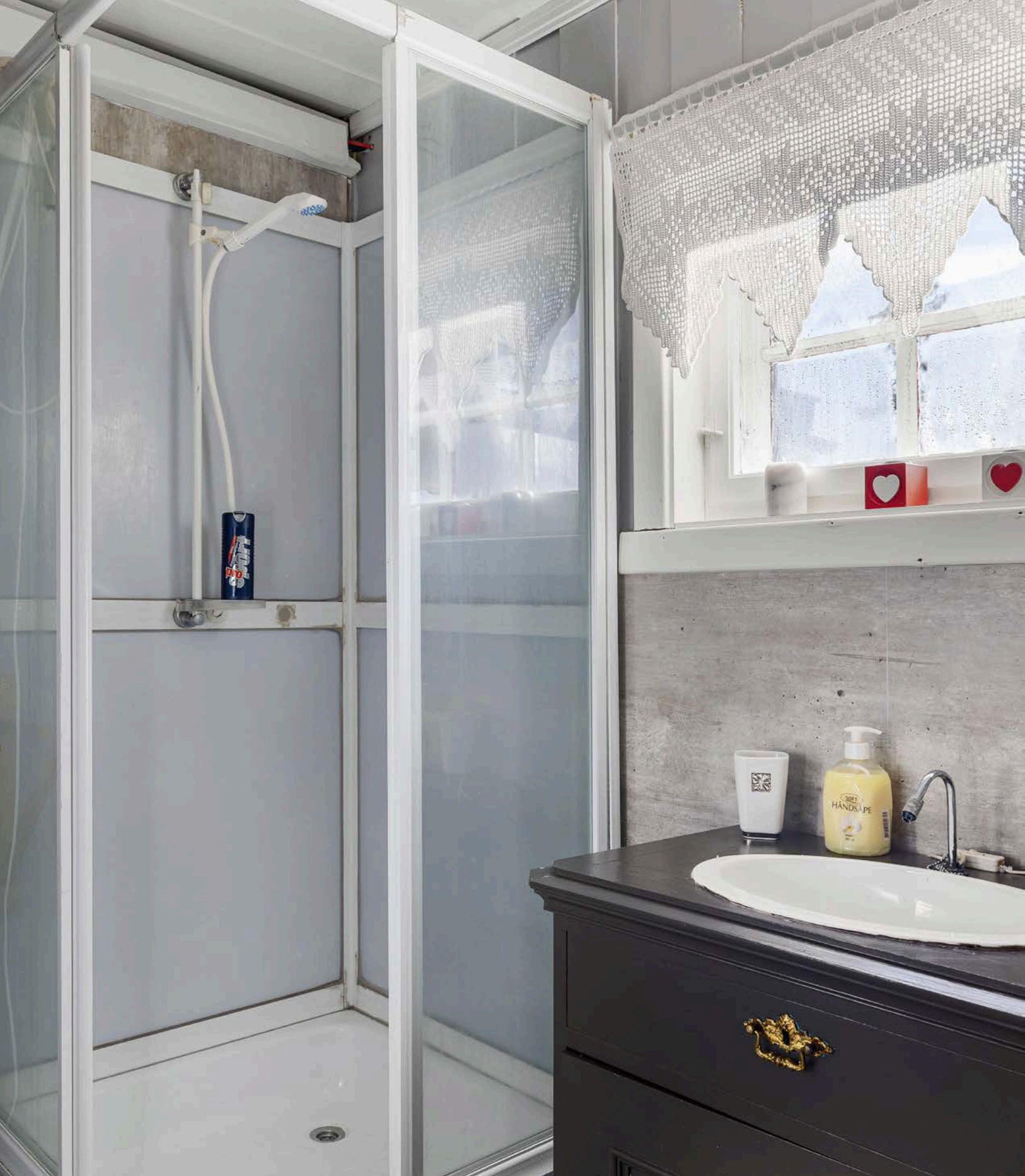
Malt kommode med nedsenket servant og dusjkabinett. Vannbeholder med elektrisk pumpe og strøm fra solcellepanel til dusj og servant. Avløp med rør ut til terreng.
