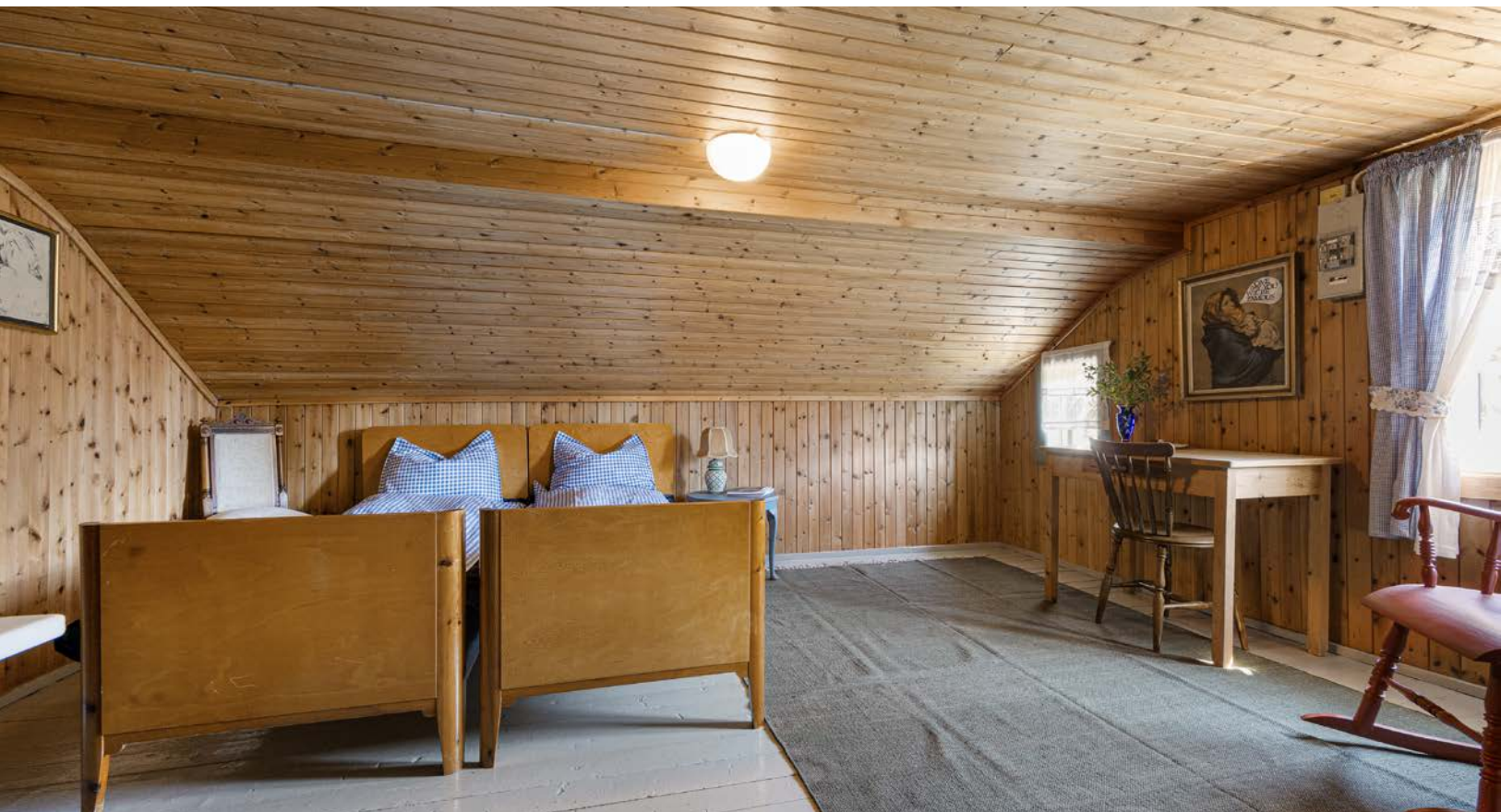
Vinduene er for små mht. dagens krav til rømningsveier og dagslysflate, og takhøyden er lavere enn dagens krav.
