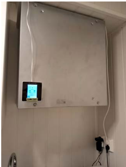
Ventilasjonsaggregat er plassert på teknisk rom/vaskerom.
