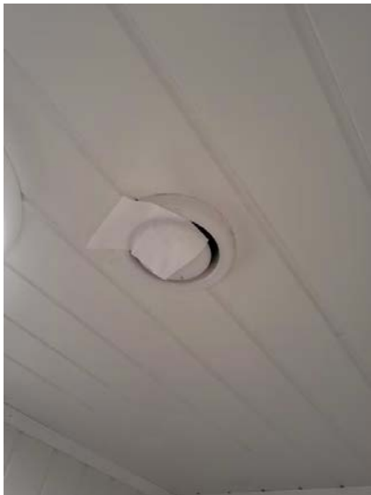
Avtrekkseffekten er testet med papir.
