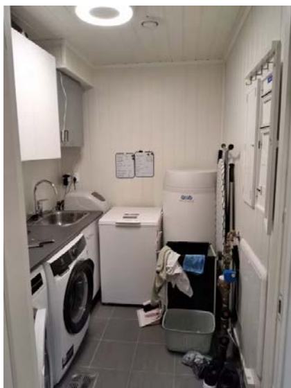
Oversiktsbilde teknisk rom/vaskerom.
