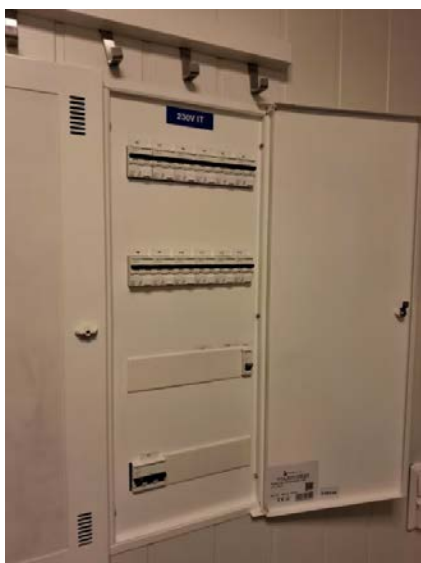
Sikringsskap er plassert i teknisk rom/vaskerom.
