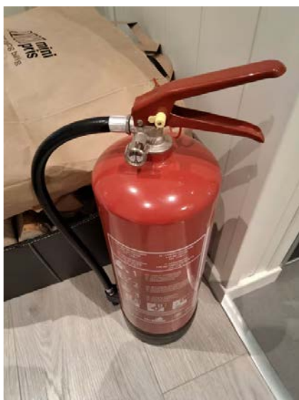
Brannslukningsapparat er sentralt plassert i boligen.
