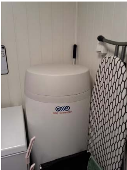
Varmtvannsbereder er plassert på teknisk rom/vaskerom.
