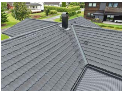
Tilkomst til takstigen er redusert av takplater montert over naboterrasse.
