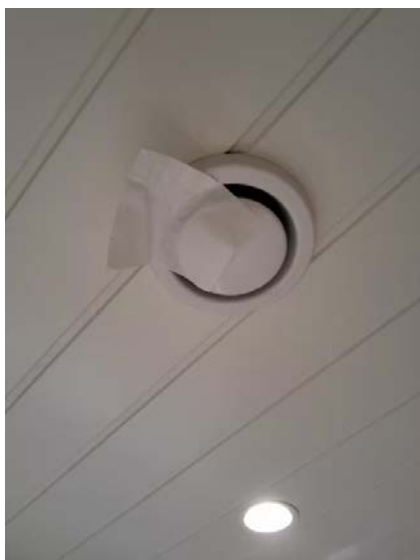
Avtrekkseffekt er testet med papir.
