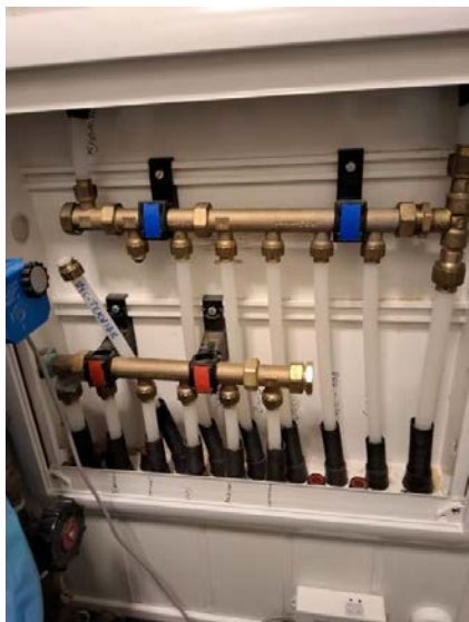
Fordelerskap er plassert i teknisk rom/vaskerom.
