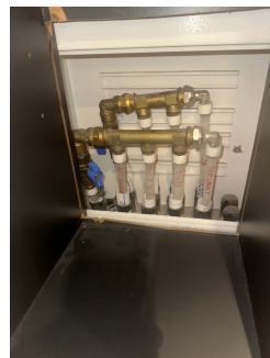
Samleskap med rørkurser og stoppekraner
