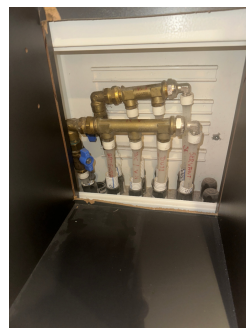
Samleskap med rørkurser og stoppekraner
