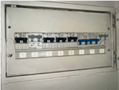
Sikringsskap med automatsikringer.
