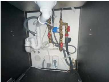
Røropplegg i kjøkkenbenk med Waterguard
