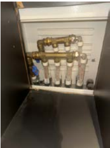
Samleskap med rørkurser og stoppekraner
