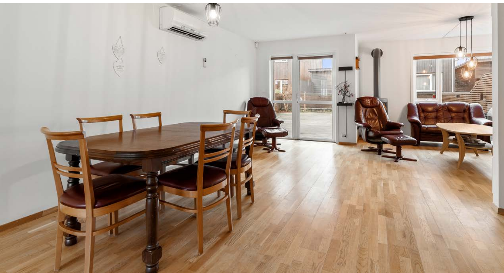
Gasspeis og varmepumpe i stuen. Varmekabler i gulv i stue 1. etg.
