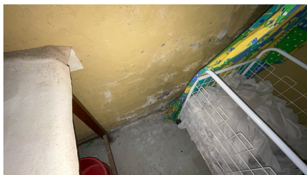
Synlig saltutslag på vegg.
