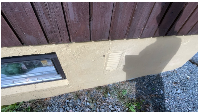
Det er påvist sprekker i murte/pussede fasader.
