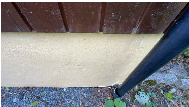
Det er påvist sprekker i murte/pussede fasader.
