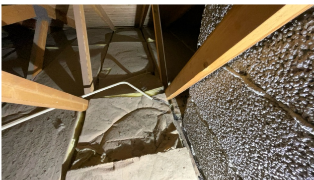
Løse ledning på loft bør fjernes.
