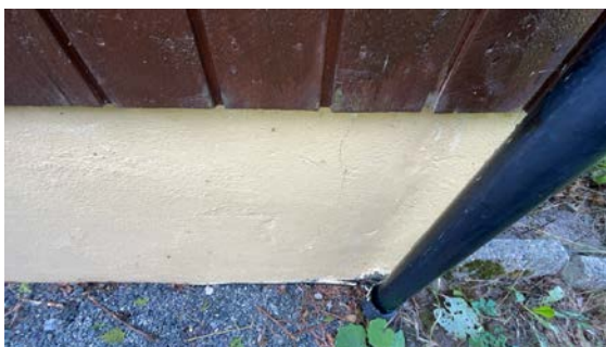
Det er påvist sprekker i murte/pussede fasader.
