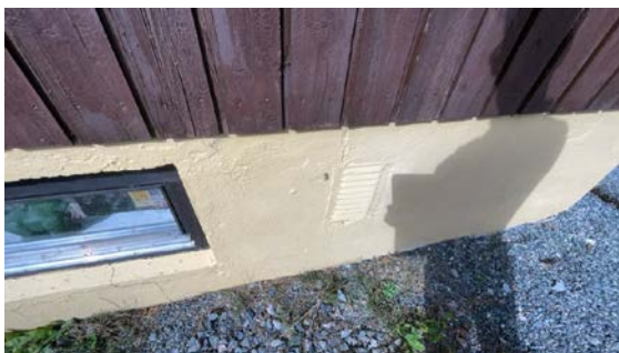
Det er påvist sprekker i murte/pussede fasader.
