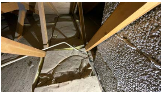
Løse ledning på loft bør fjernes.
