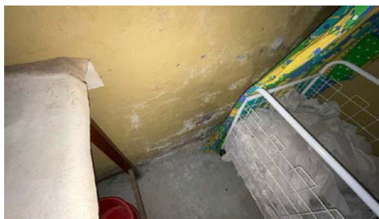
Synlig saltutslag på vegg.
