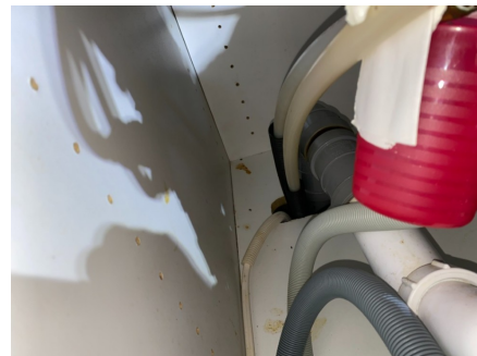
Det mangler tettemuffer i enden av varerør på kjøkken.
