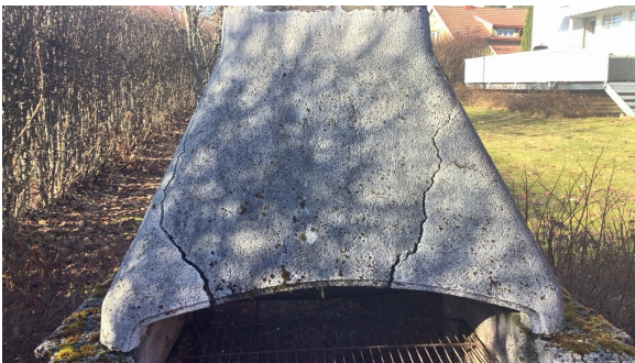
Sprekker i utepeis.
