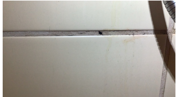
Eksempel på riss i flisfuger i dusj.
