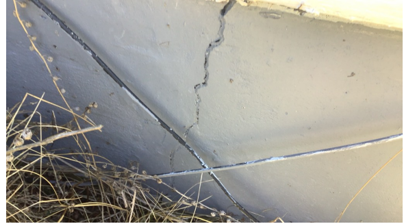
Eksempel på utvendig skråriss.
