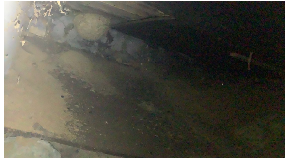
Asfaltplate har rast ned fra bjelkelaget.
