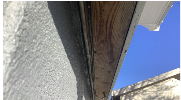
Det er ikke lufting bak bordkledning.
