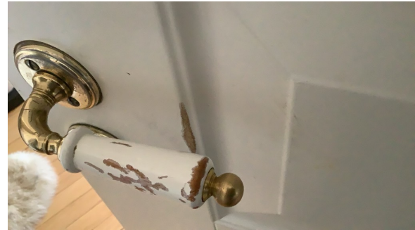
Eksempel på slitasje på dør.
