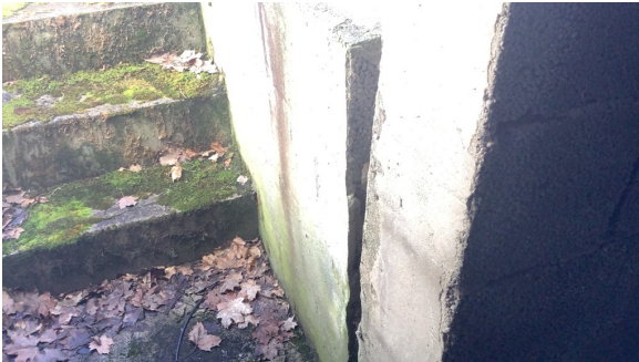
Skjevhet i murt vange for trapp.
