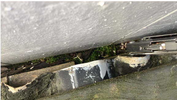
Råteskader i gulvkonstruksjonen på luftebalkong.
