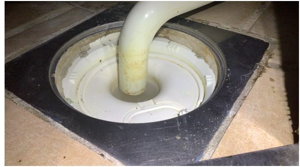
Plastsluk under badekar, og det er synlig smøremembran rundt sluk.
