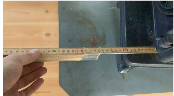
Mangelfull størrelse på ildfast materiale foran ildsted.
