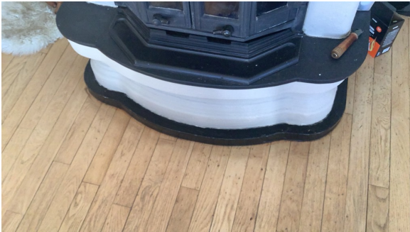
Mangelfull størrelse på ildfast materiale foran ildsted.
