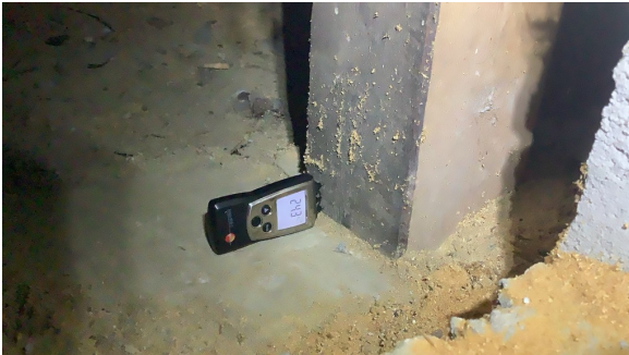
Det måles skadelig fuktinnhold i bærende stolpe.
