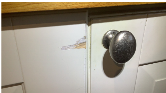
Eksempel på slitasje.
