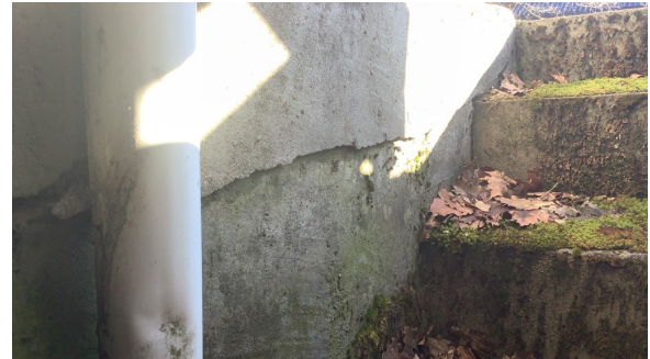
Sprekkdannelse i murt vange for trapp.
