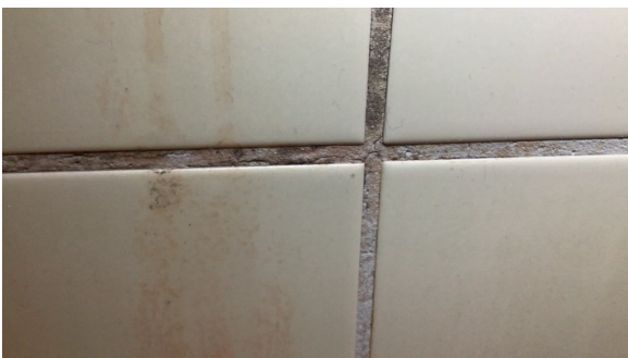
Eksempel på riss i flisfuger i dusj.
