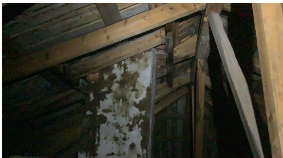
Fuktskjolder i treverk rundt pipe.
