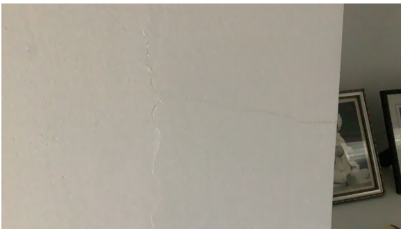
Riss i puss på pipe.
