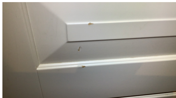
Eksempel på slitasje.
