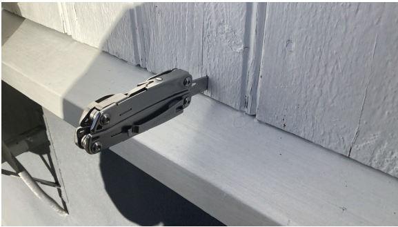
Eksempel på råteskadet kledning, og kledning går helt ned til svillebrett.
