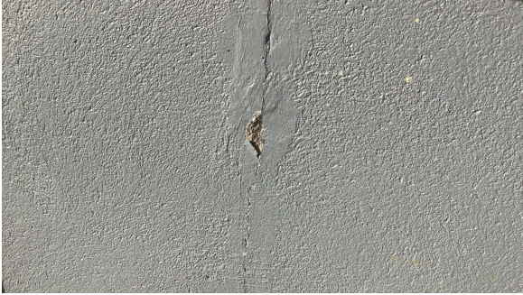
Eksempel på utvendig skråriss.
