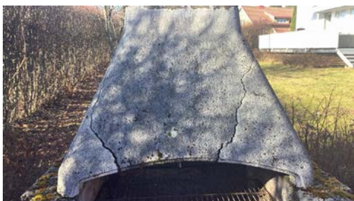
Sprekker i utepeis.
