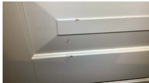
Eksempel på slitasje.
