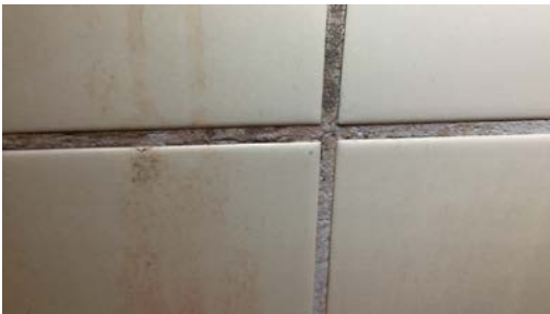
Eksempel på riss i flisfuger i dusj.
