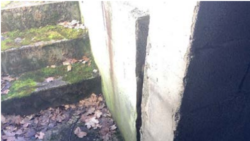
Skjevhet i murt vange for trapp.
