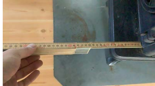
Mangelfull størrelse på ildfast materiale foran ildsted.
