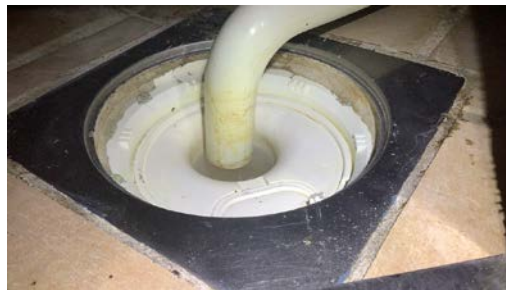
Plastsluk under badekar, og det er synlig smøremembran rundt sluk.
