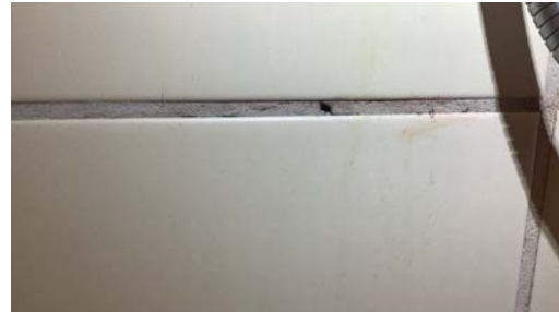
Eksempel på riss i flisfuger i dusj.
