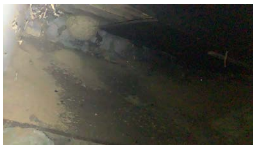
Asfaltplate har rast ned fra bjelkelaget.
