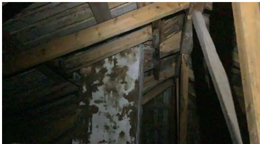
Fuktskjolder i treverk rundt pipe.
