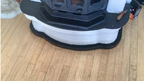
Mangelfull størrelse på ildfast materiale foran ildsted.
