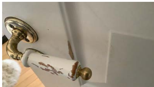
Eksempel på slitasje på dør.
