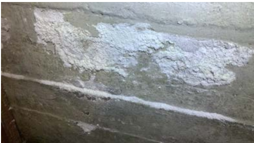
Eksempel på saltutslag.
