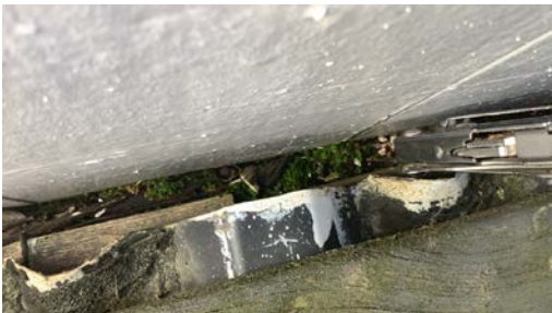
Råteskader i gulvkonstruksjonen på luftebalkong.
