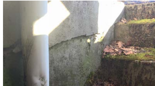
Sprekkdannelse i murt vange for trapp.
