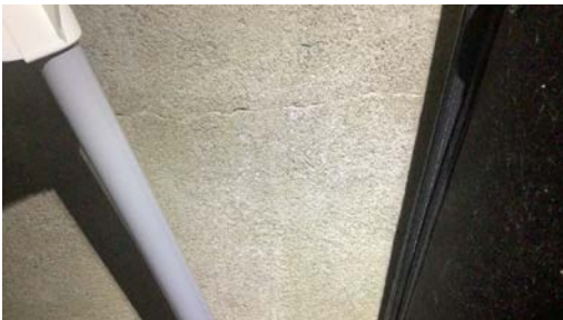
Eksempel på innvendig horisontalriss.
