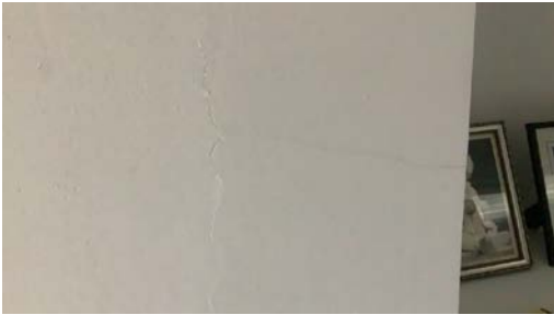
Riss i puss på pipe.
