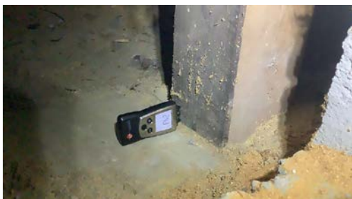
Det måles skadelig fuktinnhold i bærende stolpe.
