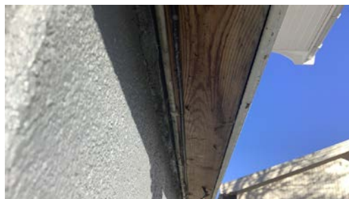
Det er ikke lufting bak bordkledning.
