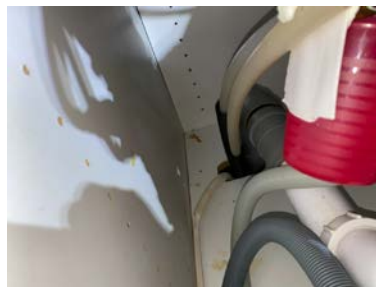
Det mangler tettemuffer i enden av varerør på kjøkken.
