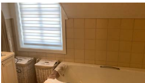
Det er ikke tettesjikt i den definerte våtsonen i skråhimling over badekar.
