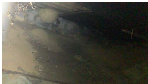
Asfaltplate har rast ned fra bjelkelaget.
