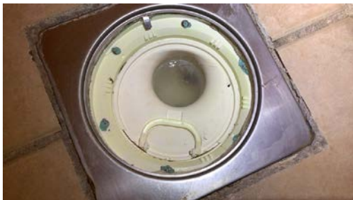
Plastsluk i dusj, og det er synlig smøremembran rundt sluk.
