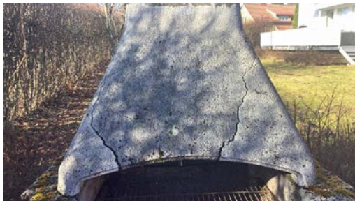
Sprekker i utepeis.
