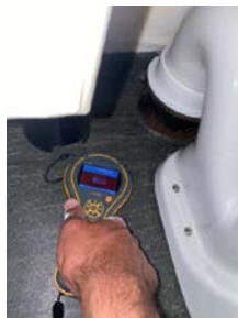
Unormale verdier rundt toalett ved fuktsøk
