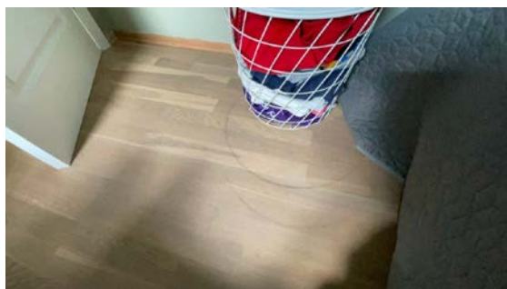
Dør til soverom i 1.et. tar i gulvet.
