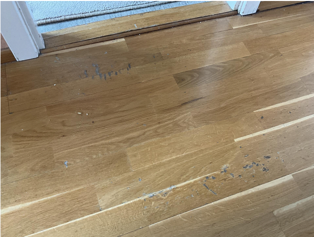
Bilde av merker og slitasje på parketten på kjøkkenet.
