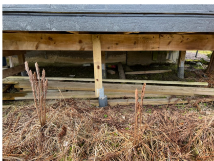
Svak fundamentering på veranda
