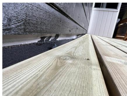
Manglende beslag på balkong
