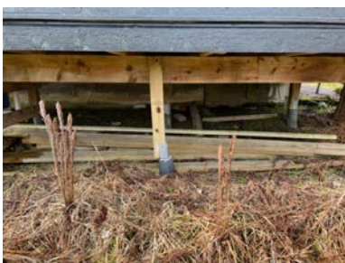
Svak fundamentering på veranda
