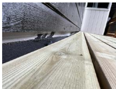
Manglende beslag på balkong
