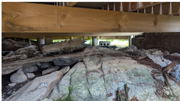
Pilarer er ikke frostsikret
