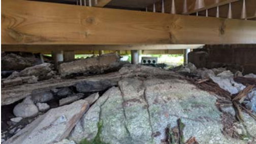
Pilarer er ikke frostsikret
